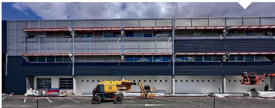
À Bruges (Gironde), Air Booster a recouvert de bardage les façades de l'UIMM.
