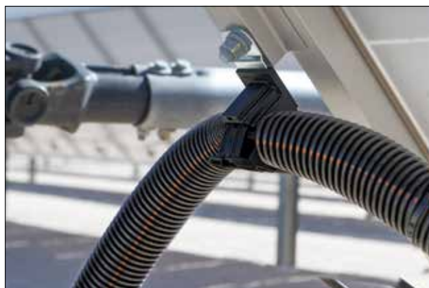
Management de câbles sur installation solaire.
